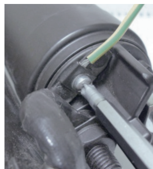
Εικόνα 3: Συνδεδεμένο καλώδιο στον ακροδέκτη 50 του μαγνητικού διακόπτη
