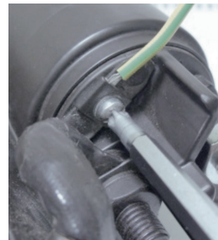
Figura 3: Cable conectado al borne 50 del solenoide
